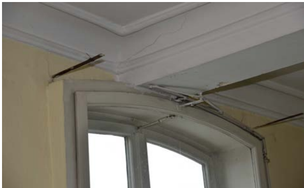
Fragwürdige Sicherungen aus der Vergangenheit haben dem Gebäude zugesetzt.
