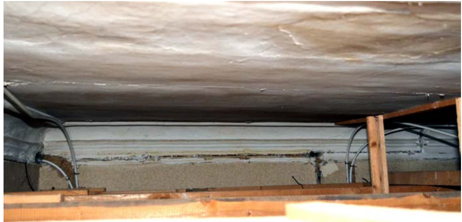
Zimmer 1/2, über abgehängter Decke haben sich noch Stuckprofile der Fr. August Zeit erhalten.
