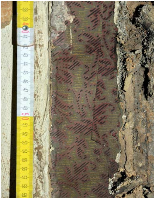
Zimmer 1/2, ältere Tapete hinter Zwischenwandanschluss. (vgl. EG, R3).
