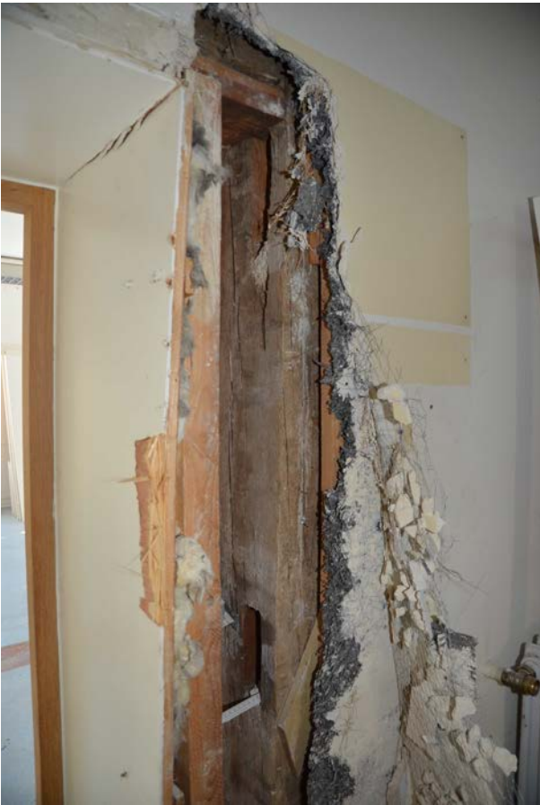
Abb. B 9: Befund 7, Wandpfosten links von heutiger Tür, mit Zapfenloch des ehemaligen Brustriegels sowie eingeschleiftes Brett unter Sturzriegel
