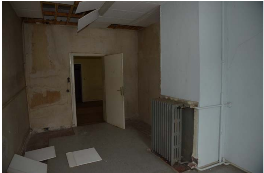
Zimmer 3 (Flur), der bis zum Anschluss an einer im Nachbarhaus liegenden Heizung letzter genutzter Schornstein.
