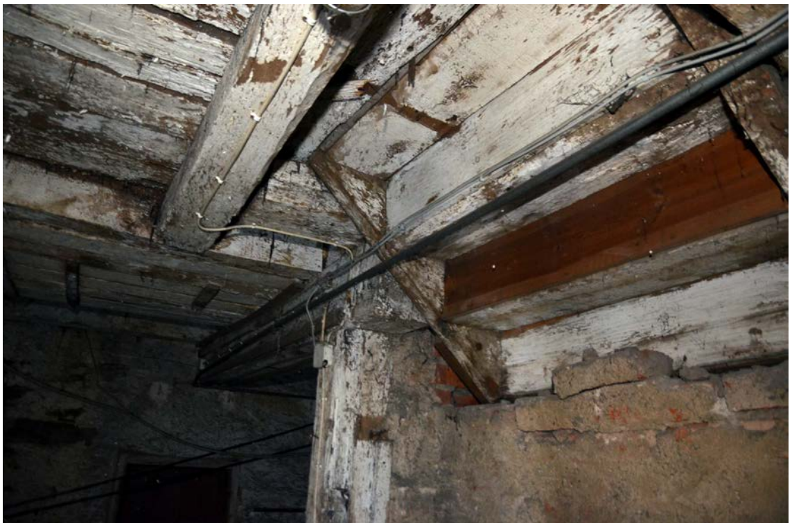
Untersicht Treppe mit Wechselbalken, darüber Bohlen von der Mauer bis zur Treppe.
