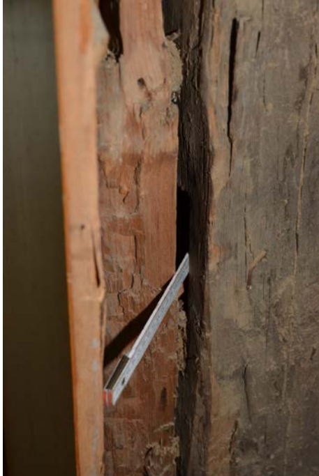
Flur2, Westwand, der Brustriegel ging ehemals durch und wurde für den Türereinbau ausgebaut.
