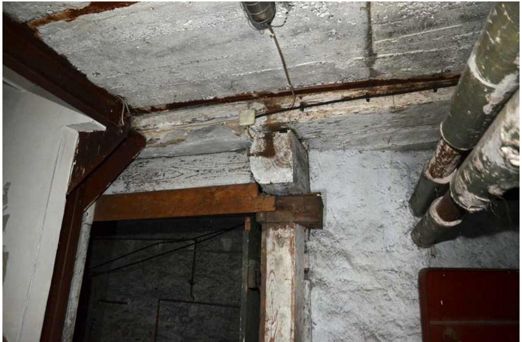
Unterzug unter Deckenbalken zw. Treppe u. Zugang Gewölbekeller, Tür zum hinteren Kellerraum nach Norden.
