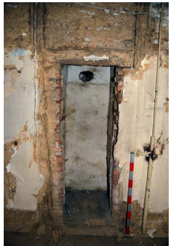
Flur 2, Ofennische in der Ostwand, dahinter liegt die Ecke des Saals. Ofenrohranschluss.
